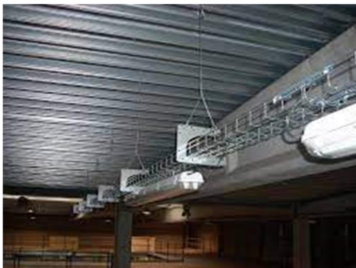
Figure 26 : Photographie d'un chemin de câble en acier galvanisé et de câbles solaires
