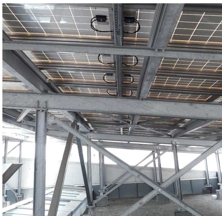
Figure 24 : Vue en sous face des modules (structure métallique en acier inoxydable)
